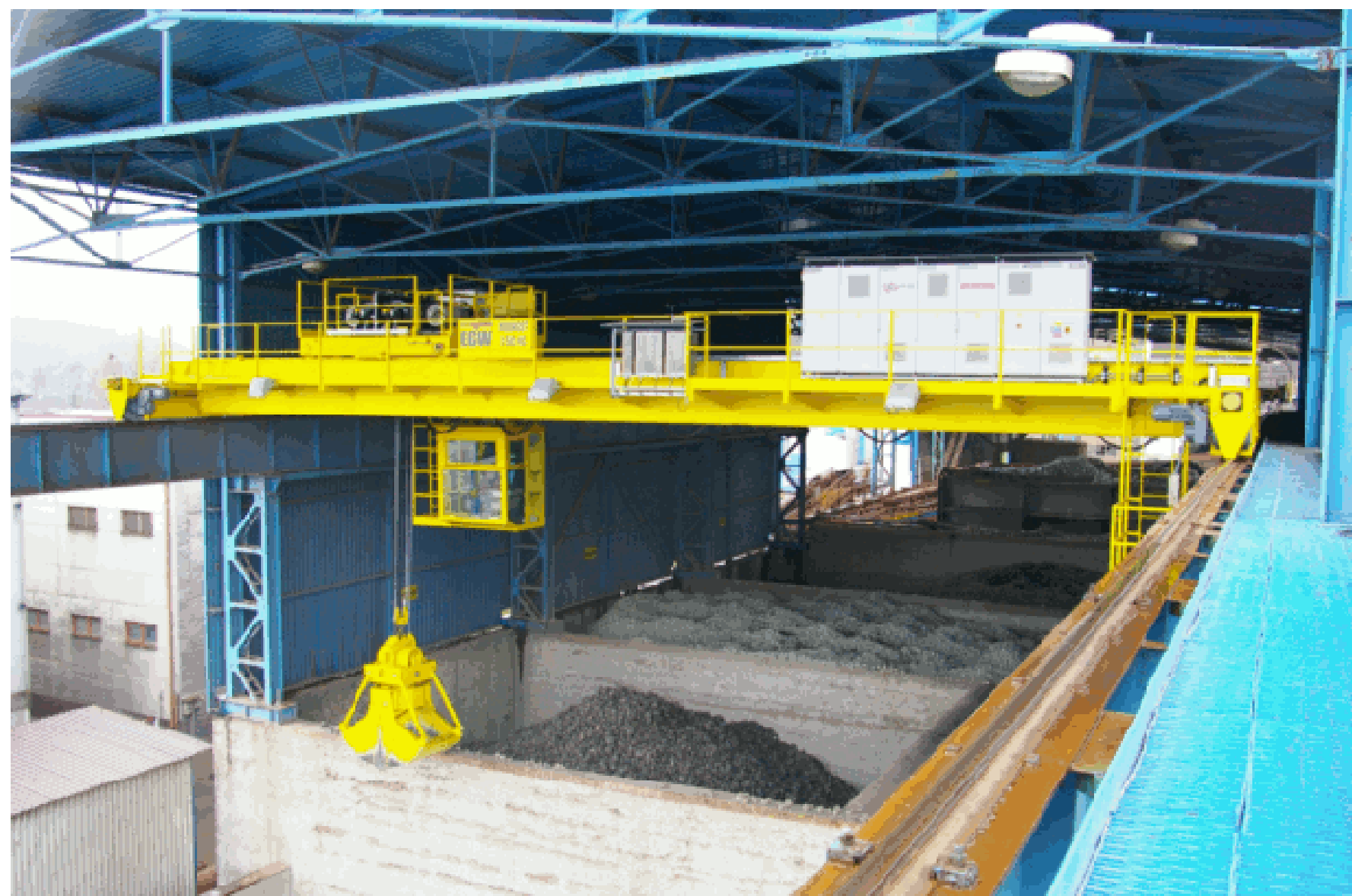
Obr. 1: Zadaný mostový jeřáb
